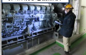
非常用発電機点検
