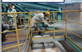
水噴霧ノズル点検
