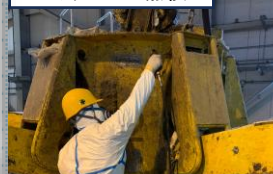
ごみクレーン点検
