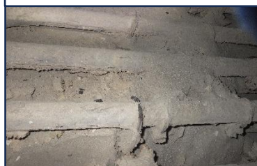
炉内水管（清掃前）
