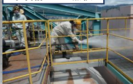
水噴霧ノズル点検
