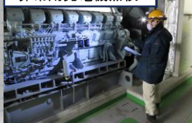
非常用発電機点検
