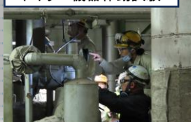
ボイラー機器作動試験
