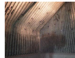
ボイラー水管（焼却炉内）
