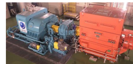
蒸気タービン・発電機
